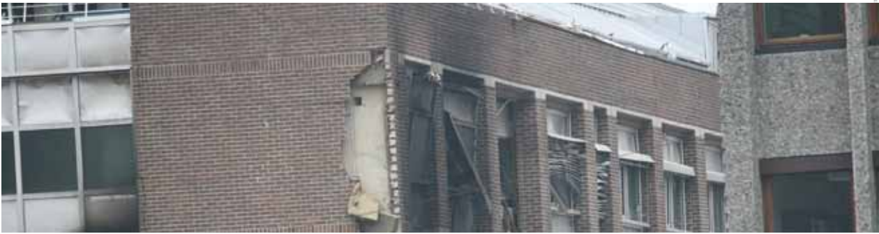
Maltrakterte bygninger i regjeringkvartalet etter terroren 22. juli
